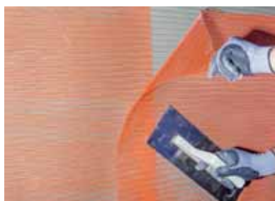
Слика 2 Мрежата од стаклени влакна треба да се нанесе на првиот слој од површинскиот малтер кога е сè уште влажен со притискање од врвот до дното и широко растегнување, без превиткување и поставување на еднакво растојание од изолационата плоча до целата површина. Во спојниците, мрежите од стаклени влакна секогаш треба да се преклопуваат за 10 cm.
