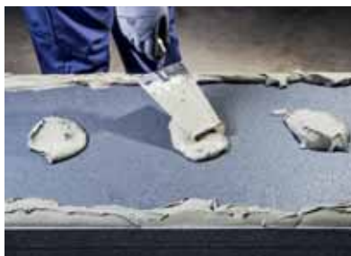
Слика 2 Доколку има разлики во нивоата или нерамнини на површината, адхезивниот малтер се нанесува како ленти по сите рабови на задниот дел, и како точки во средните делови на термоизолационата плоча со мистрија, користејќи го методот за нанесување на ленти и точки.
